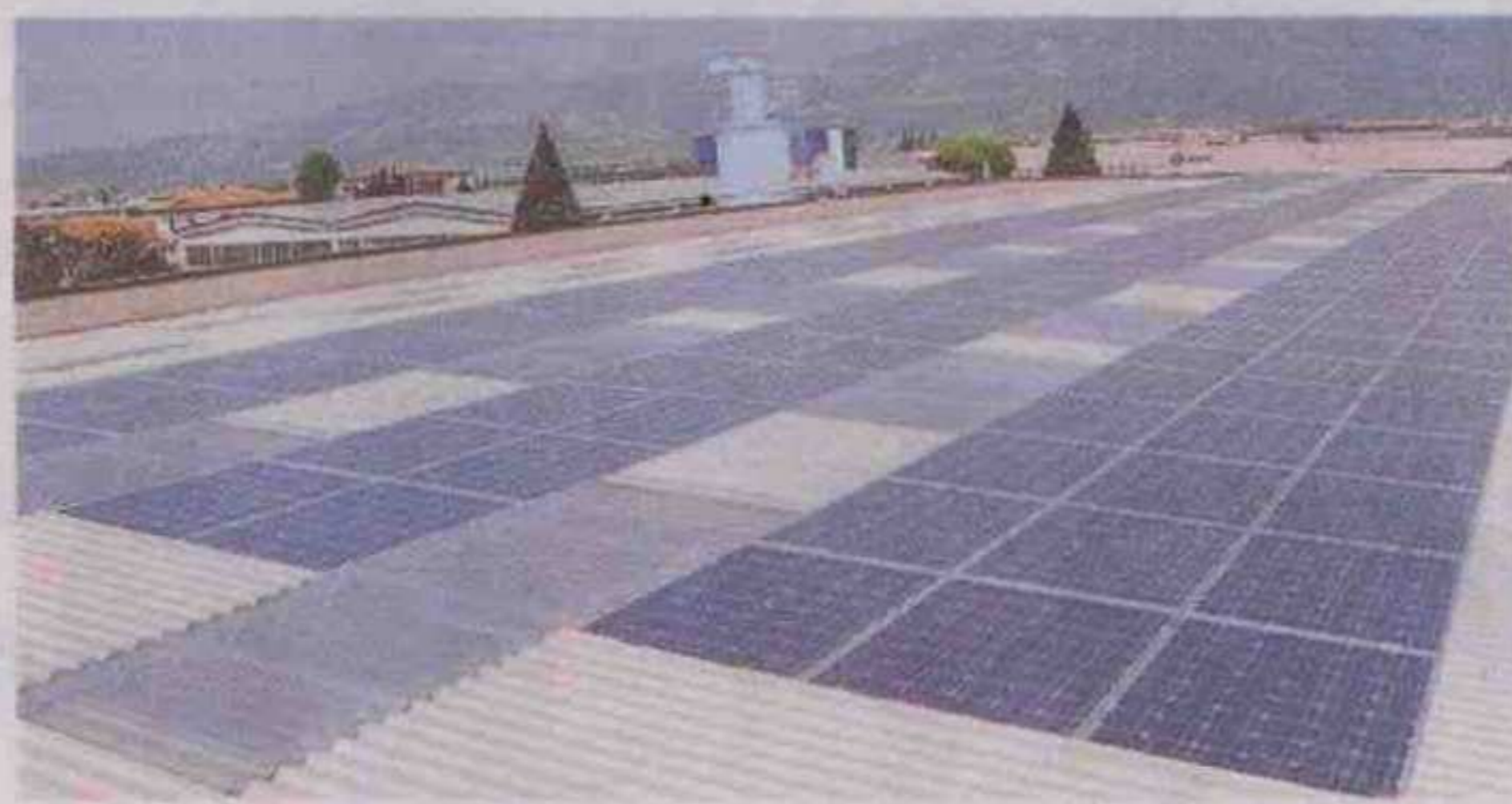
I 550 pannelli solari installati dalla Nettuno FOTO SANMARCO
